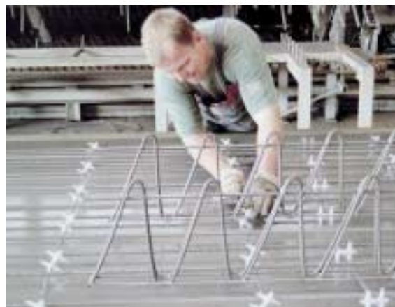
Bild 10. Einbau von hohen und langen Elementen Fig. 10. Installation of high and long elements
