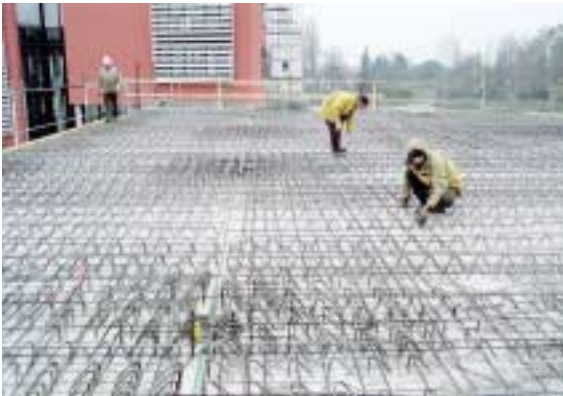
Bild 14. Einbau der unteren Biegezugbewehrung auf der Baustelle Fig. 14. Installation of the lower flexural reinforcement on the construction site
